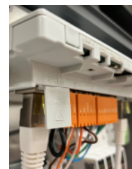
Vue RJ45 onduleur
